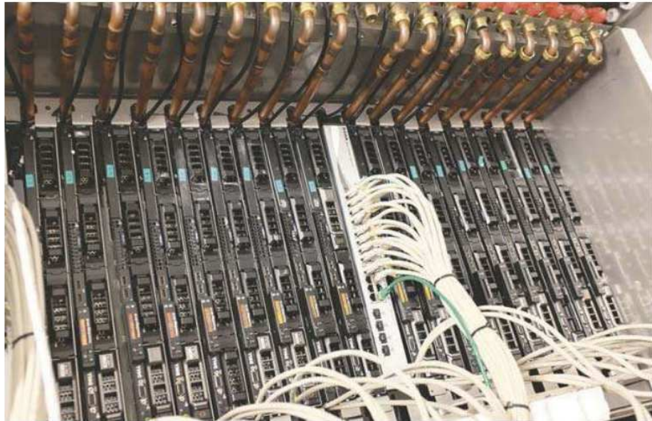
L'intérieur d'une chaudière numérique Stimergy avec ses dix-huit serveurs immergés dans un bain d'huile.
